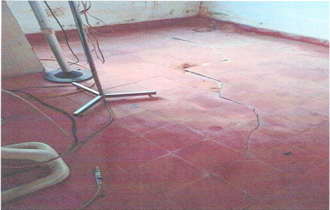
Imagen 3: Se observa pisos agrietados por hundimientos de la estructura.
