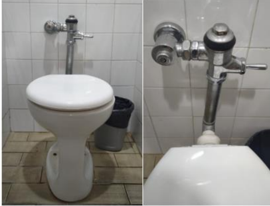
Figura 3 – Válvulas de inodoro instaladas
